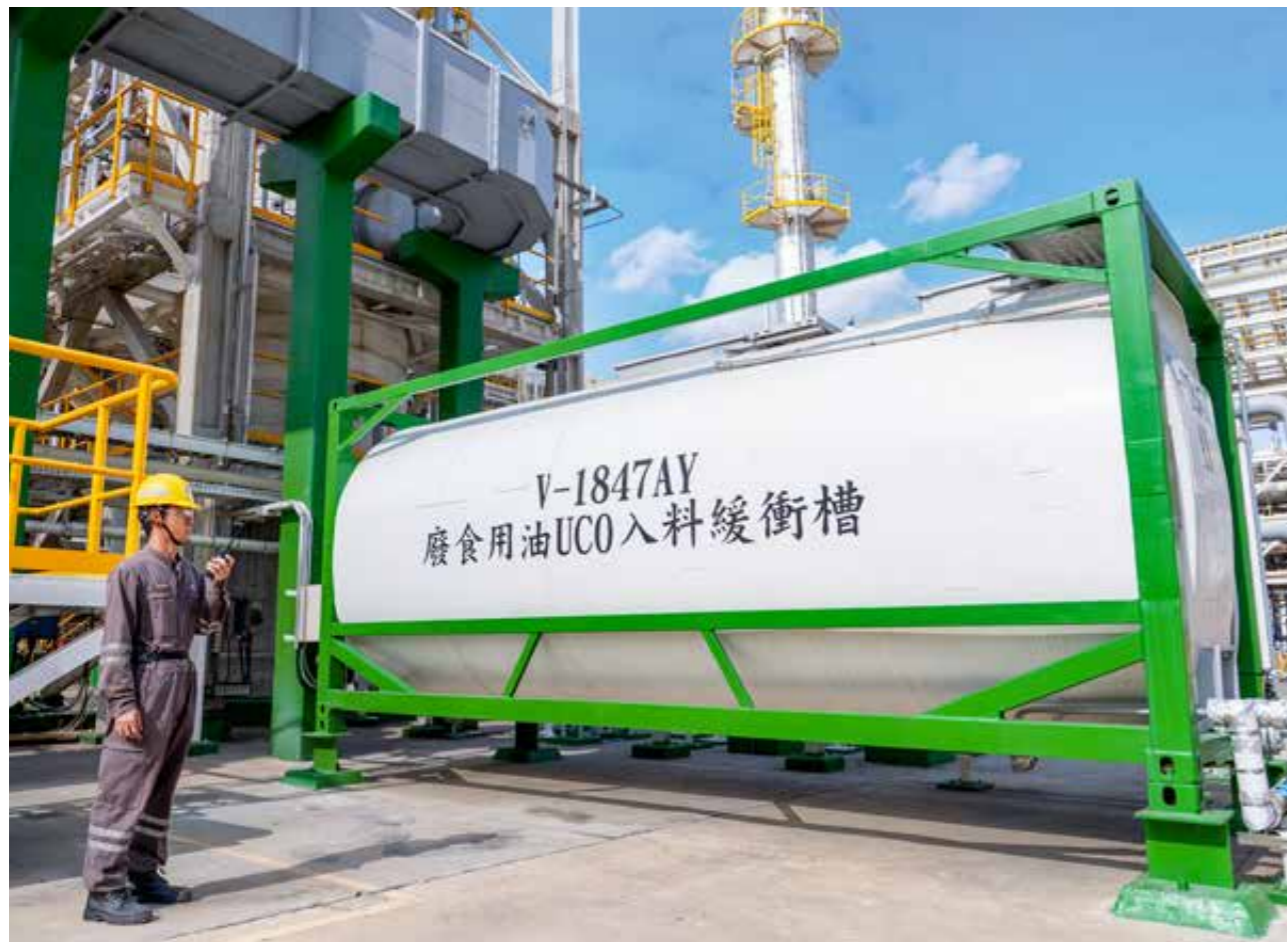
廢食用油設備
